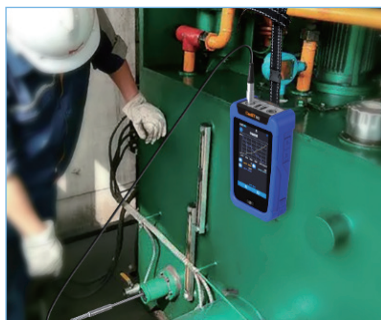
现场悬挂使用
